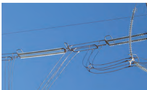
Cadeia de Ancoragem e Suspensão entre Pórtico e Primeira Torre
