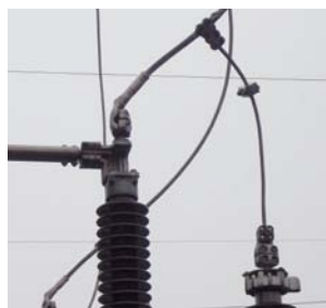
Conjunto de Conectores
