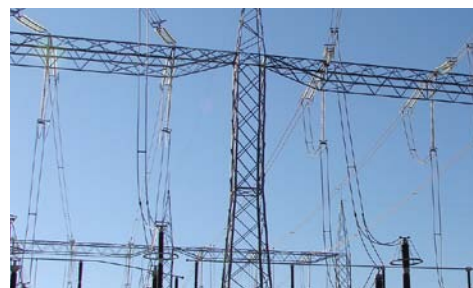
Cadenas instaladas en el Pórtico
